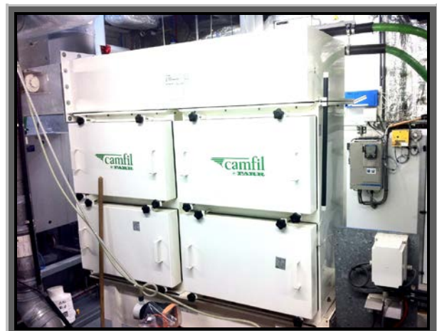
Figuur 12: Actieve koolfilters op een ventilatiesysteem voor uitstoot via de schoorsteen
